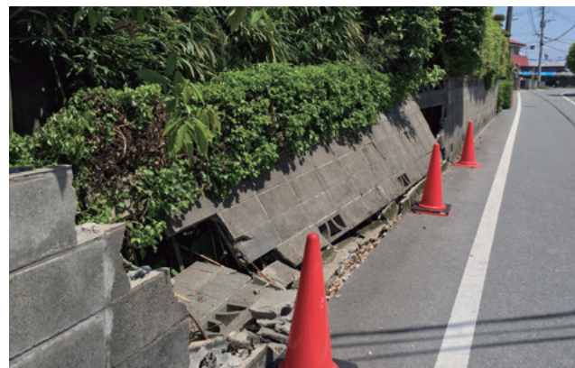
熊本地震被害
