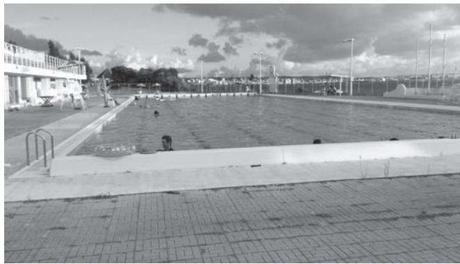
改修が待たれる町営プール
