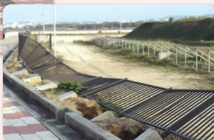
早急な転落防止柵の復旧を！
