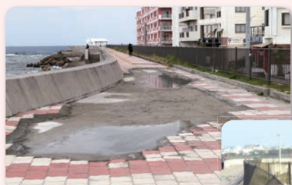
インターロッキングブロックの被害状況
