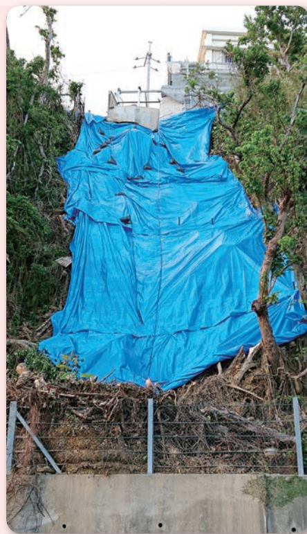
応急措置後の北玉区の地滑り
