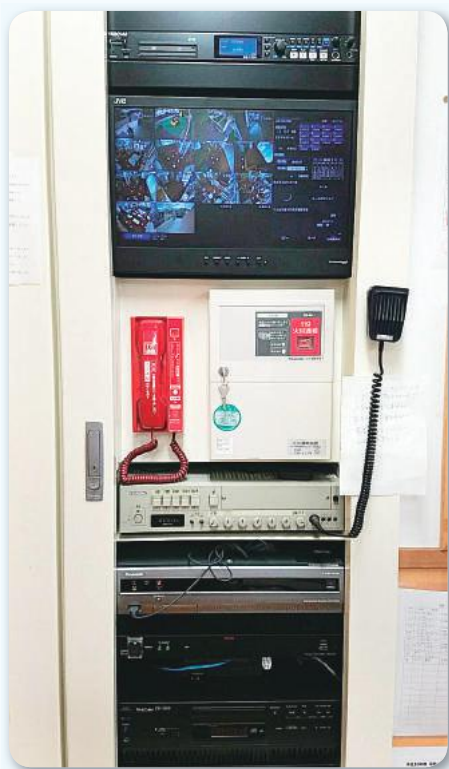
110番非常通報装置の設置は
