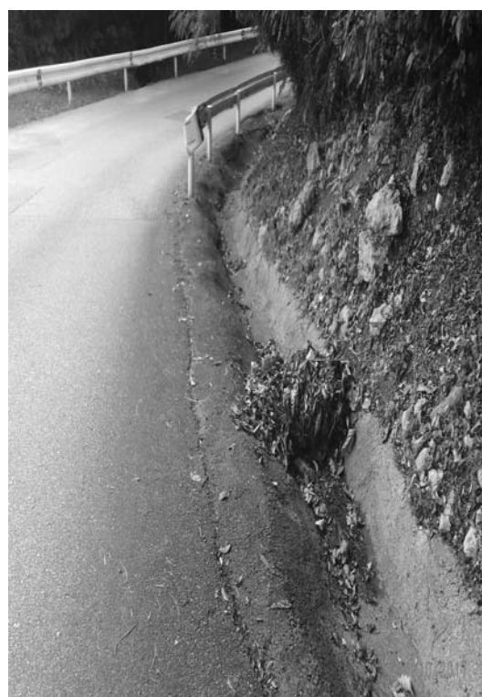
危険な17号線側溝が歩道がわり
