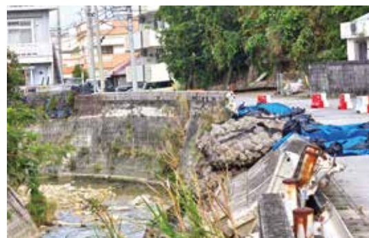
住民は不安を抱えている 県へ早い河川拡幅工事の要請を
