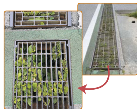
雨水排水路に繁茂する雑草。早期対策を望む！
