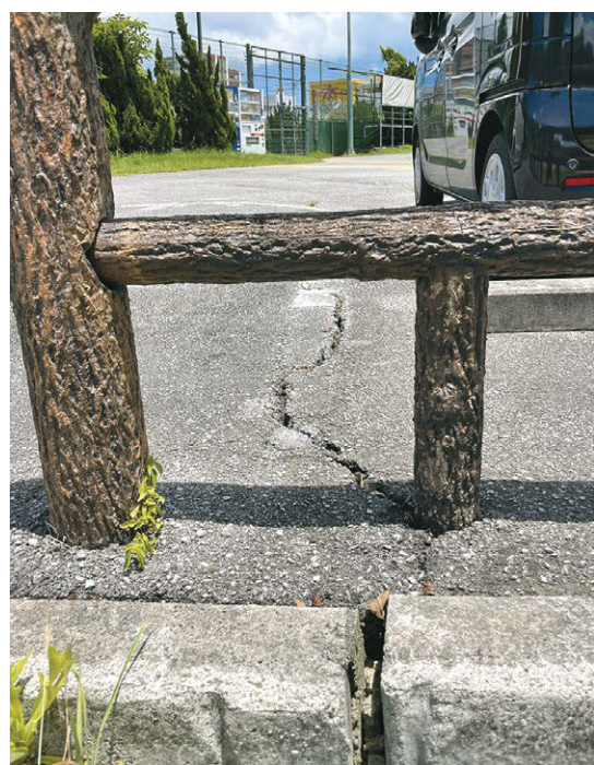
地盤沈下の調査、処置を強く望む！
