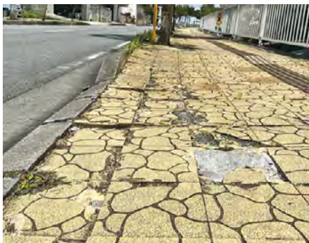
破損した通学路！早急な対応を！
