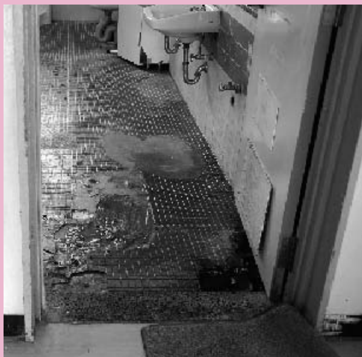
老朽化した桑江中学校トイレ
