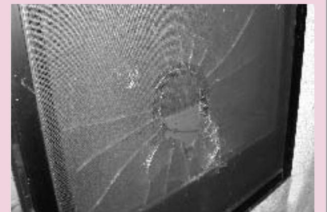
投石で損壊した窓ガラス
