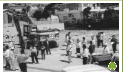
北玉児童館建設事業 ■建築面積 561.19㎡ ■敷地面積 2033.85㎡ ■事業費 1億4763万円(16年度～17年度) ■工期 平成17年1月20日～同7月20日
