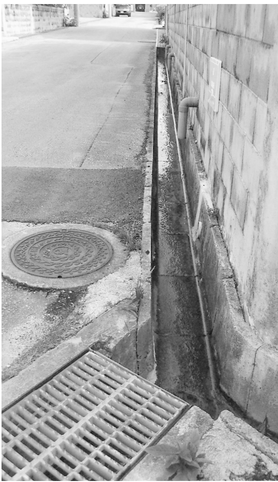
早急な整備が望まれている側溝
