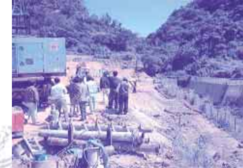
かけ崩れのため工事が難航しています。
